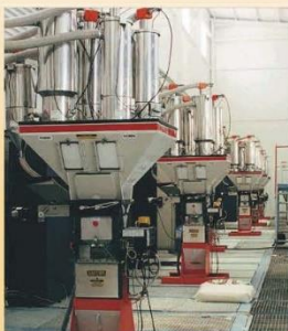
Instalación en planta de extrusión
