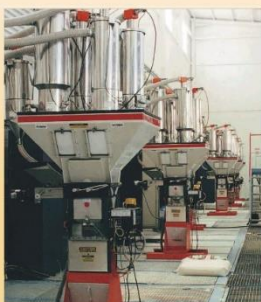
Instalación en planta de extrusión
